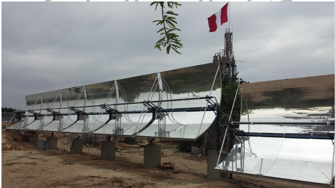
Esquipo solar instalado y operando.
