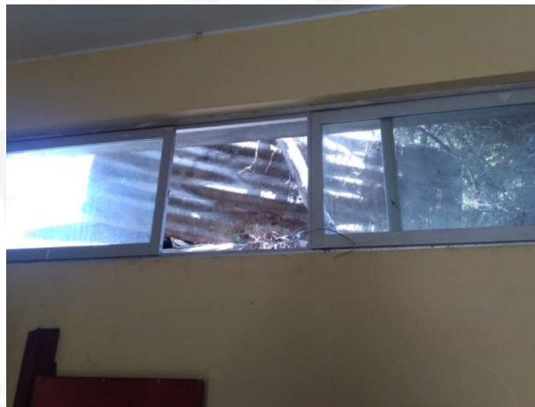
Figura 17 Peligro en ventanas
