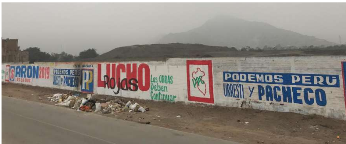
Figura 117 Contaminación visual y residuos sólidos en muro límite con el terreno
