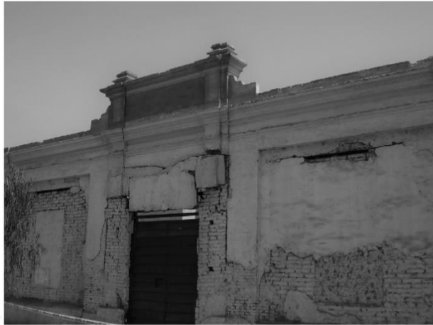
Muro en mal estado
