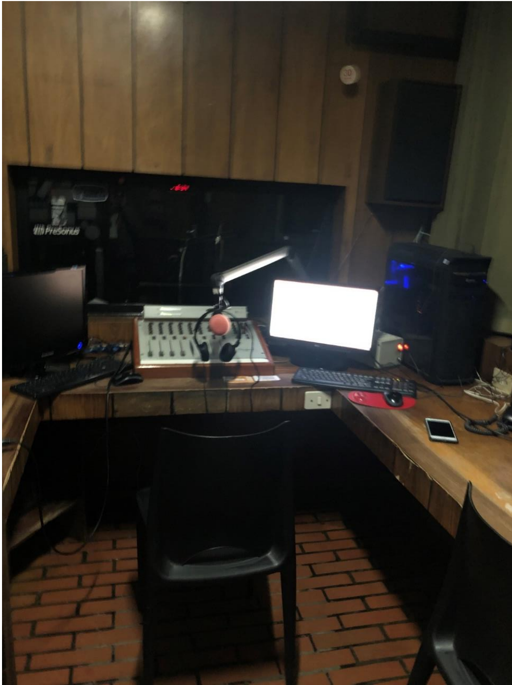
Cabina de transmisión al aire por frecuencia modulada de Radio San Francisco.
