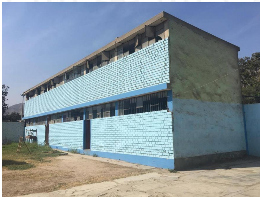
Figura 10. Edificio declarado inhabitable
