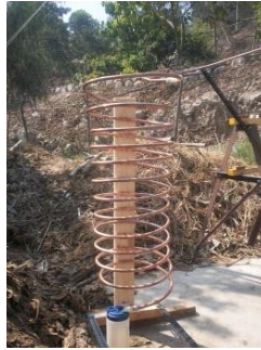
Figura 11 – Fotografía del condensador (intercambiador de calor). No necesita un sistema de refrigeración.
