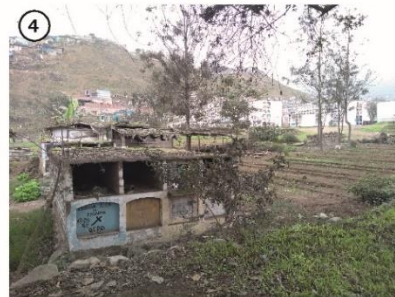
4 Nichos en mal estado y en la parte posterior el una caseta del encargado de los cultivos.
