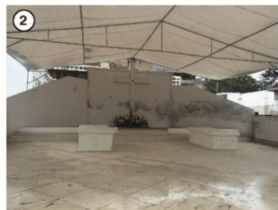
2 Zona de velatorio totalmente abierta, se presentan problemas de humedad en época de invierno por encontrarse en zona de Lomas
