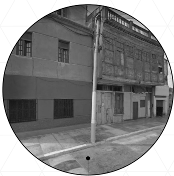
Balcón republicano de cajón Materiales: Madera Estado: Mal estado de conservación, Ruinoso
