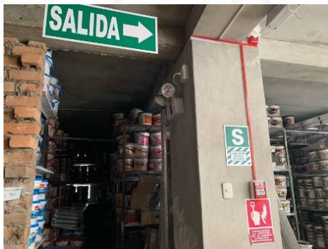
Señalización en zonas de seguridad, rutas de escape, alarma contra incendios y extintores
