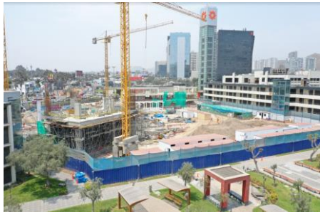
Cámara 2: Pabellón D3 (F)
