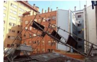
Caída de altura
