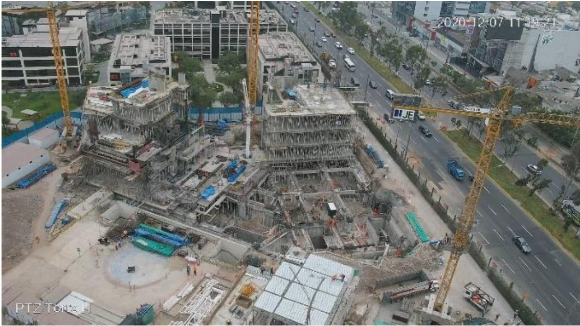
IMG-400 (07-12-2020/Torre H/PTZ)
