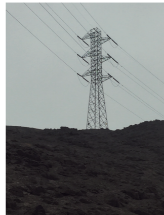
Torres de alta tensión
