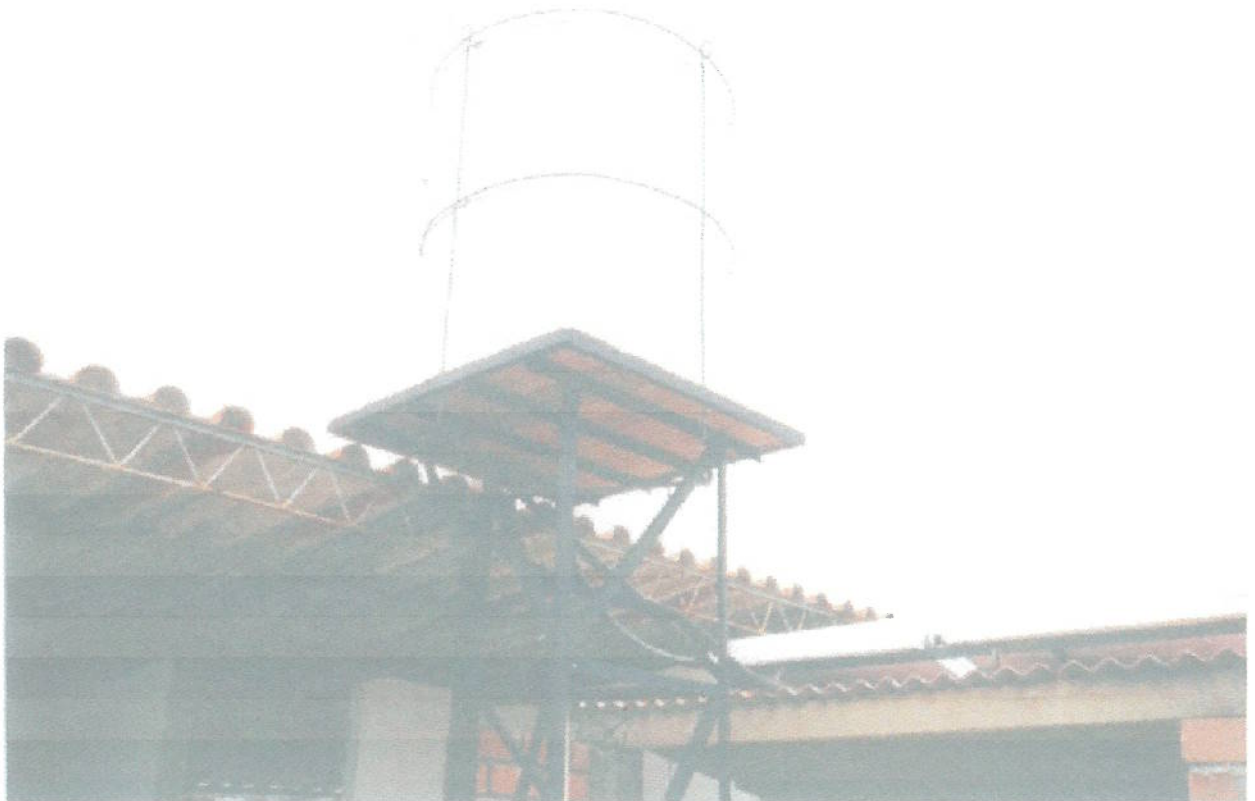
Figura 5. Sistema de 500 lts. instalado en Hotel Regina de Caraz.
