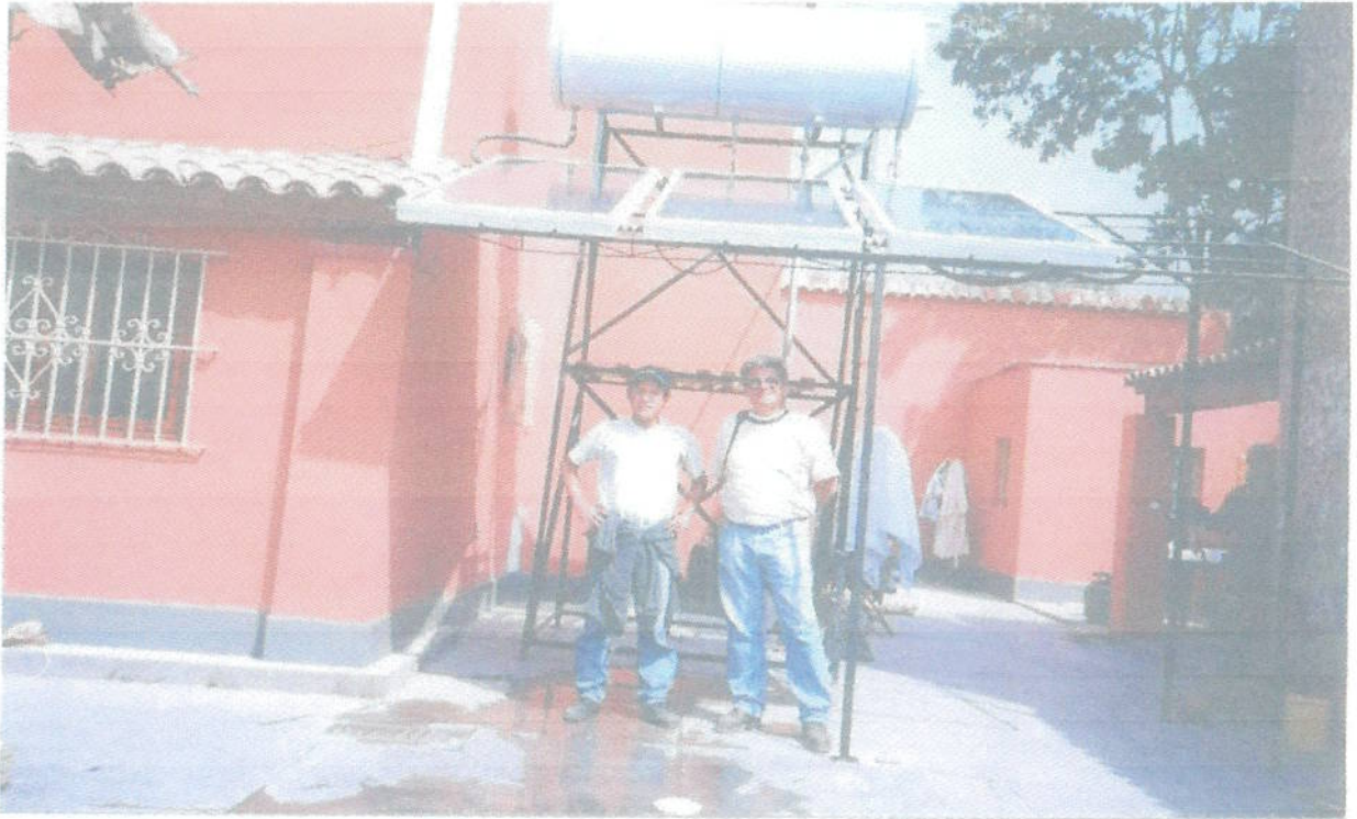
Figura 4. Sistema de 500 lts. instalado en convento de Chaclacayo.
