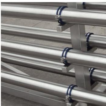
Tuberías de transporte en acero inoxidable
