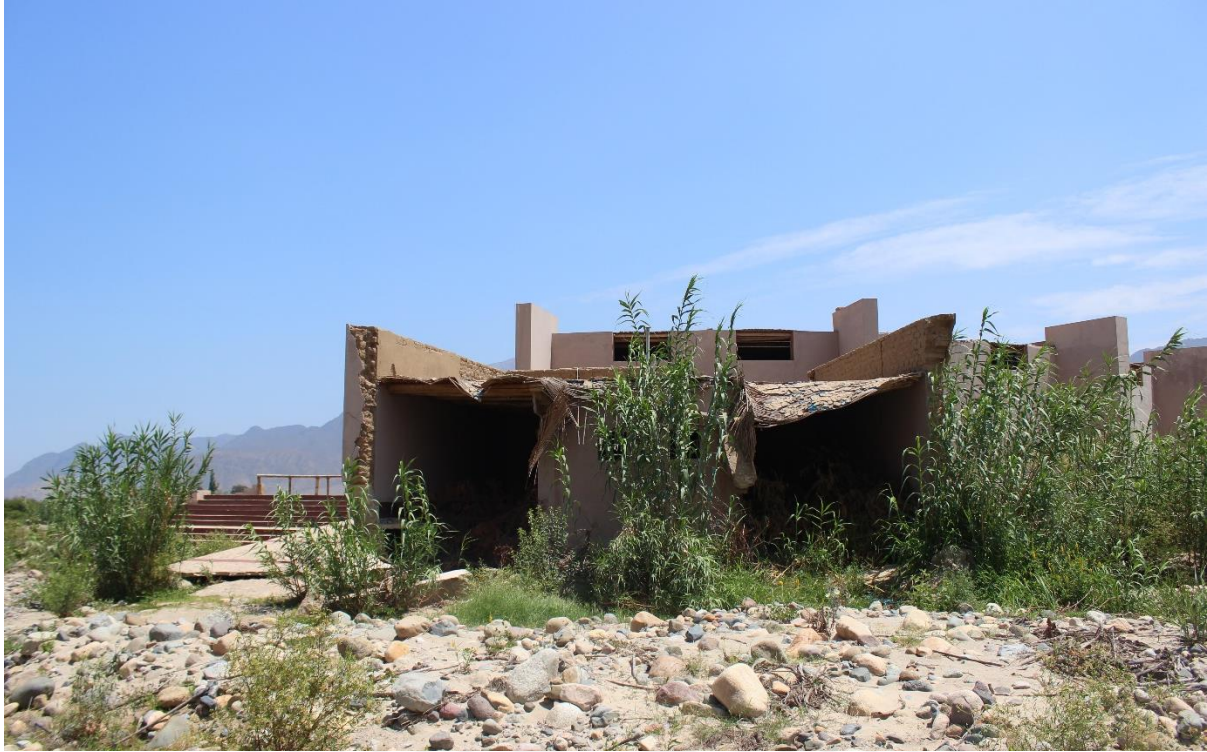
Imagen 46: Recepción destruida por el Fenómeno del Niño Costero – Fuente: Foto propia
