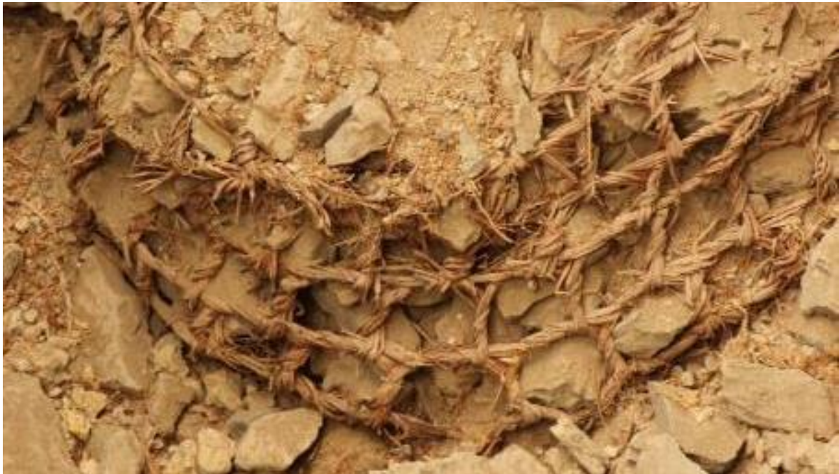
Imagen 14: Shicra visible tras el desprendimiento de piedras – Fuente: Foto propia
