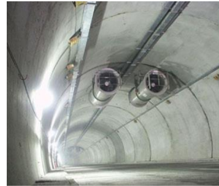
Figura 1. Sistema de ventilación mecánica. Fuente: systemair, s.f.
