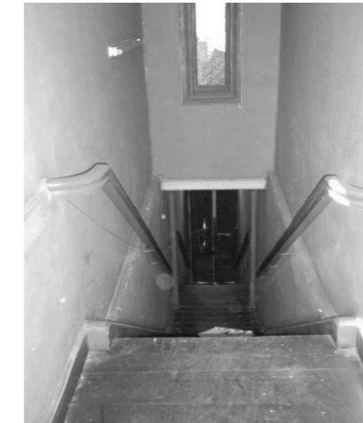
Imagen 99. Casona Villán: Estado de las escaleras. Fuente: Delgado (2013).
